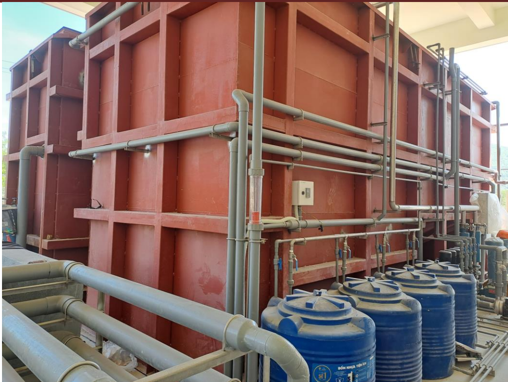
Hình 3.2. Hệ thống xử lý nước thải của Nhà máy
